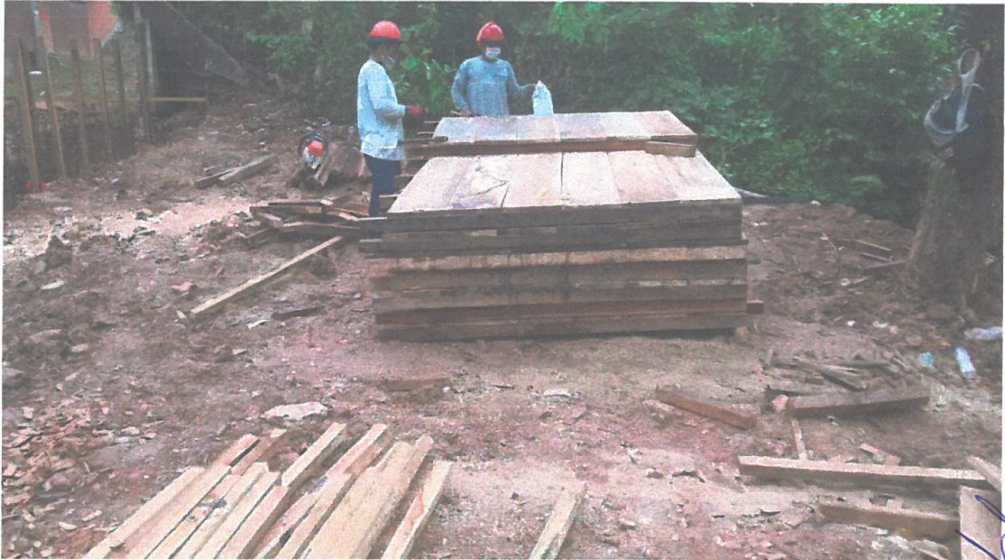
FOTO N° 05: EN LA VISTA SE OBSERVA AL PERSONAL REALIZANDO LA ABILITACION DE PANELES PARA ENCOFRADO EN MUROS DE CONTENCIÓN.
