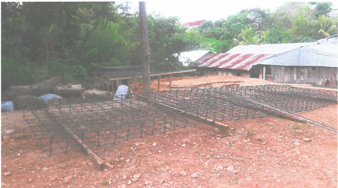
FOTO N° 02: EN LA VISTA SE OBSERVA AL PERSONAL REALIZANDO LOS TRABAJOS DE ABILITACION DE ACERO EN ZAPATAS CONTINUAS PARA MUROS DE CONTENCION
