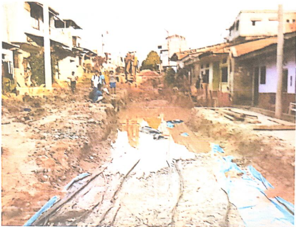
PROTECCION DEL FONDO DE LA EXCAVACION CON PLASTICOS. AGUA ESTANCADA DESPUES DE UNA LLUVIA TORRENCIAL.
