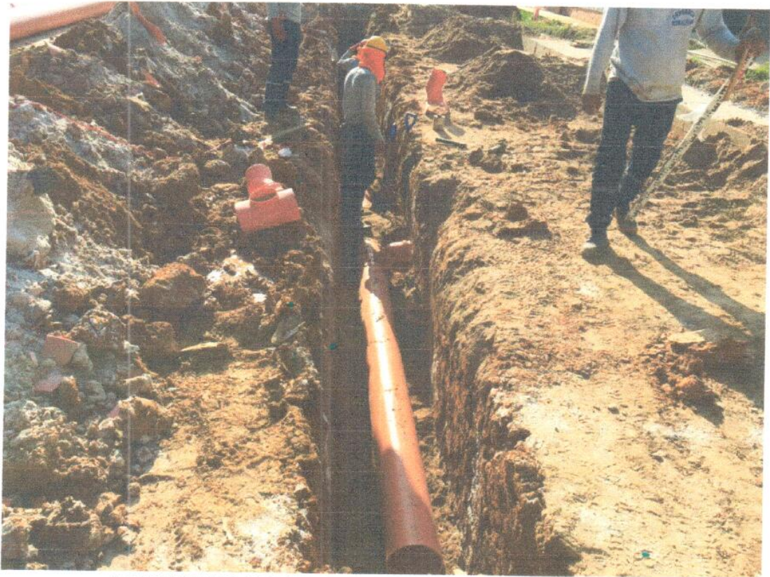
COLOCACION DE LAS CACHIMBAS ANTES DE PROTEGER CON ARENA GRUESA LA TUBERIA DE DESAGUE.
