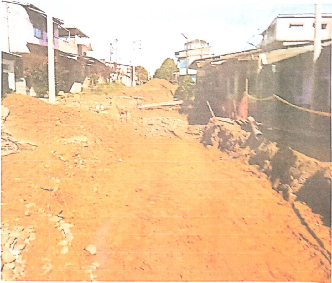
DESPUES DE RETIRADO EL AGUA ESTANCADA, RELLENO CON MATERIAL DE PRESTAMO LUEGO DEL RELLENO CON OVER EN LA CUADRA 07.
