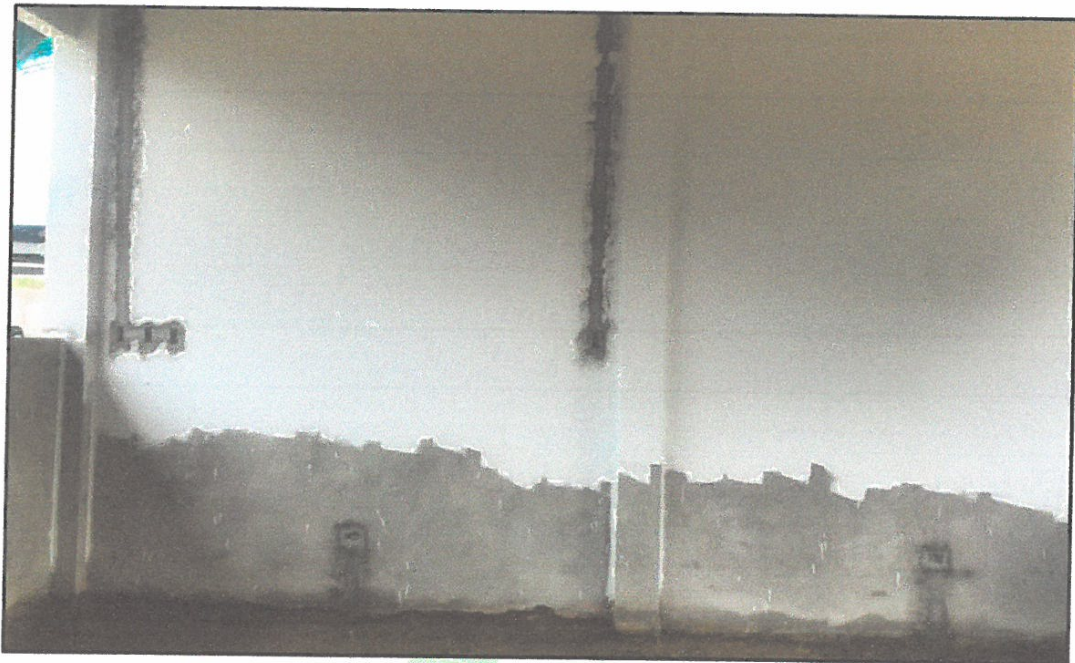
FOTO N° 13: PICADO DE PARED PARA COLOCACIÓN DE CONDUCTORES EN INSTALACIONES ELECTRICAS PARA SALIDAS DE TOMACORRIENTES Y INTERRUPTORES
