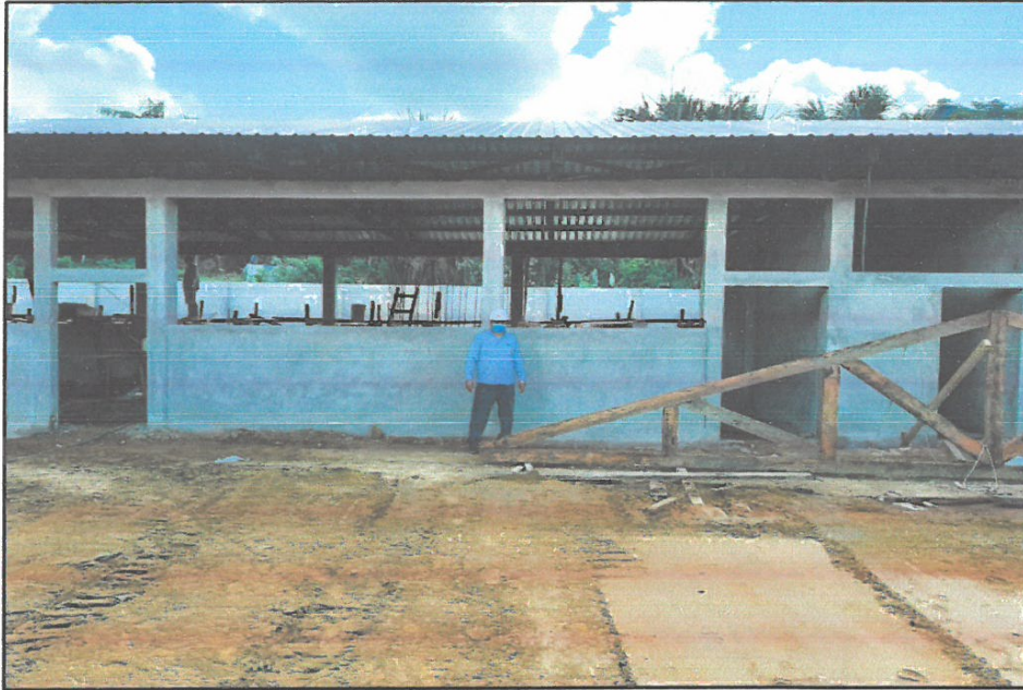
FOTO N°13: TARRAJEO EN MURO INTERIOR, EXTERIOR DE MODULOS, ASI COMO EN VANOS, VIGAS Y COLUMNAS.
