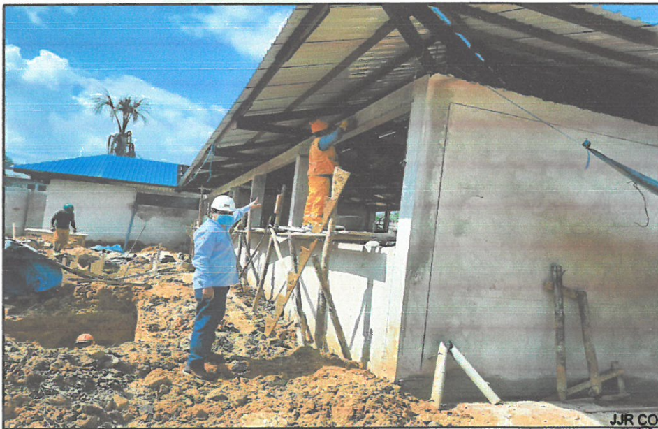
FOTO N°14: TARRALEO EN VIGAS.
