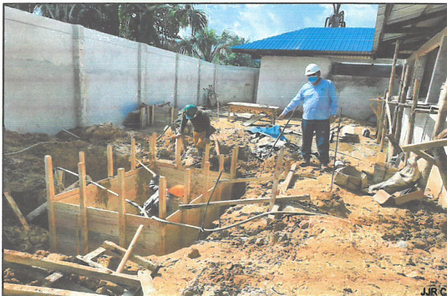
FOTO N°08: ENCOFRADO DE LOSA INFERIOR DE CISTERNA, ASI COMO PARA PLATEA DE CIMENTACION DE TANQUE LEVADO
