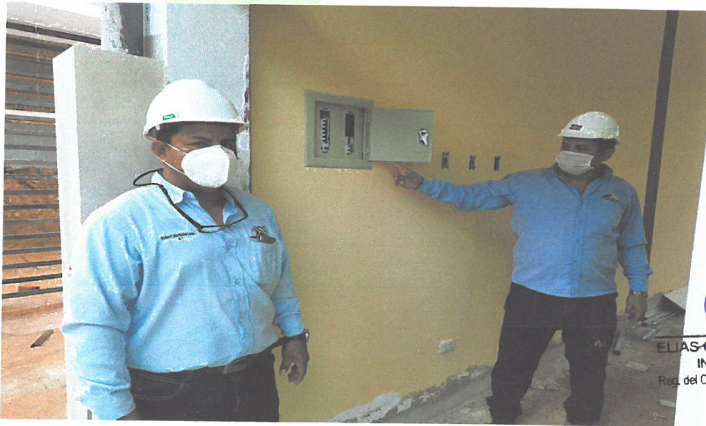
FOTO N° 06: FUNCIONAMIENTO DE TABLERO DE DISTRIBUCION EN MODULOS
