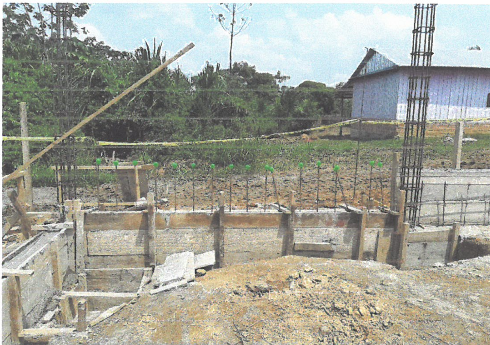
Foto N° 18: Vista del vaceo de concreto en sobre cimiento armado del cerco perimétrico de la obra "Mejoramiento y Equipamiento del servicio Educativo N 62200 Barrio Carabanchel - San Lorenzo, Distrito Barranca, Provincia Datem Del Marañón - Loreto"
