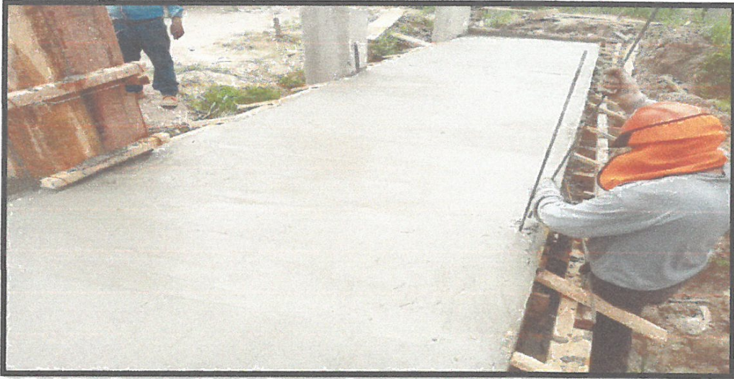
FOTO N°03: EN LA FOTO SE OBSERVA EL VACEO MORTERO f_c=210 kg/cm 2 EN LA RAMPA DE ACCESO DE LA I.E
