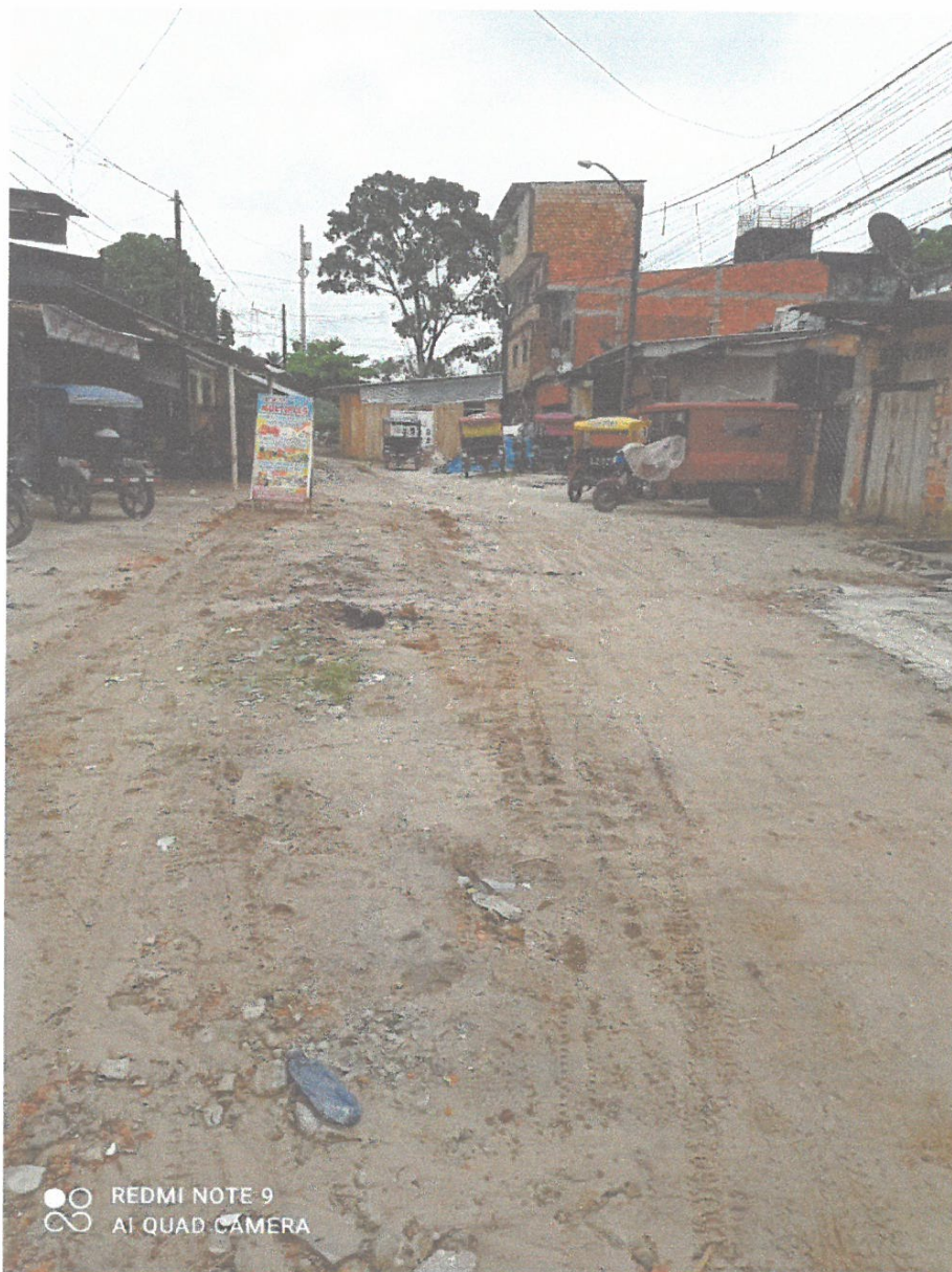
Pasaje Atlántida es otra intersección de Calle Libertad que se encuentra inmersa en la obra y que no registra intervención alguna. Actualmente sirve como puesto de almacén de la obra.
