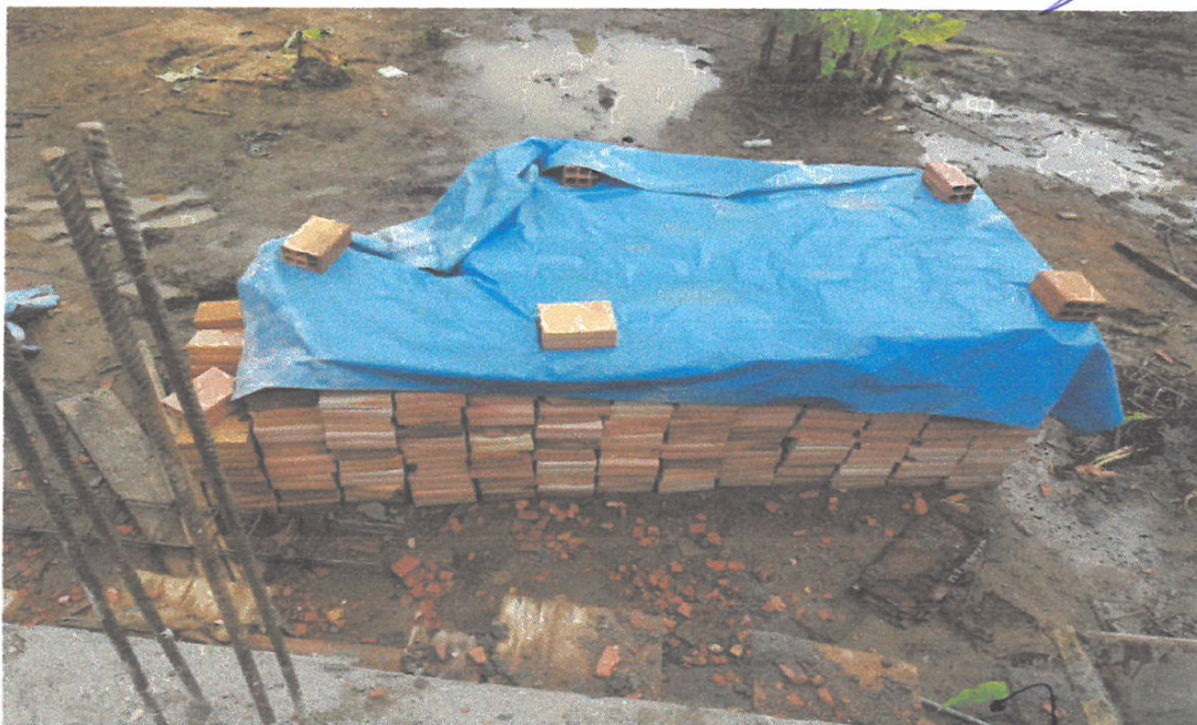
FOTO N°06: EN LA FOTO, se muestra el acopio o almacenamiento de ladrillo para la posterior construcción de los muros.
