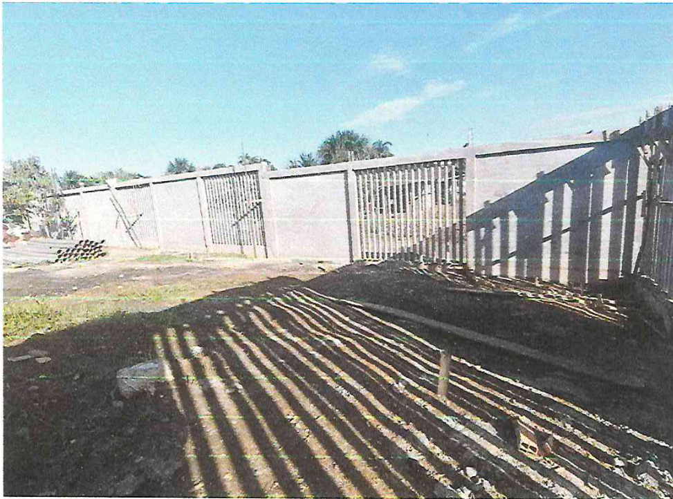
Foto N° 05: Vista del tarrajeo del cerco perimétrico en la obra "Mejoramiento y Equipamiento del servicio Educativo N 62200 Barrio Carabanchel - San Lorenzo, Distrito Barranca, Provincia Datem Del Marañón - Loreto" .
