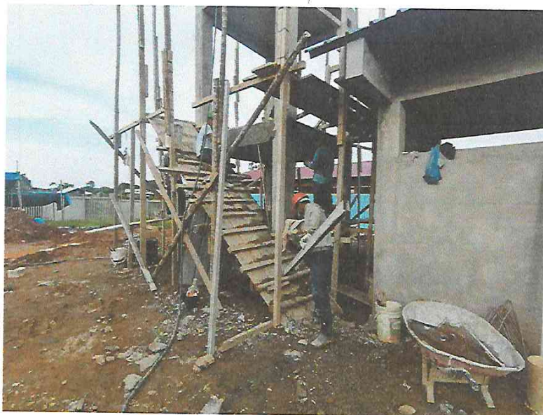
FOTO N°08: Vista del tarrajeo frotachado de vigas y columnas del tanque elevado en la obra "Mejoramiento y Equipamiento del servicio Educativo N° 62200 Barrio Carabanchel - San Lorenzo, Distrito Barranca, Provincia Datem Del Marañón - Loreto".
