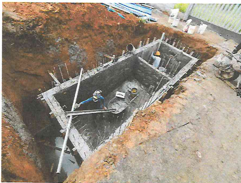
FOTO N°12: Vista del tarrajeo de los muros interiores del tanque séptico en la obra "Mejoramiento y Equipamiento del servicio Educativo N° 62200 Barrio Carabanchel - San Lorenzo, Distrito Barranca, Provincia Datem Del Marañón - Loreto".
