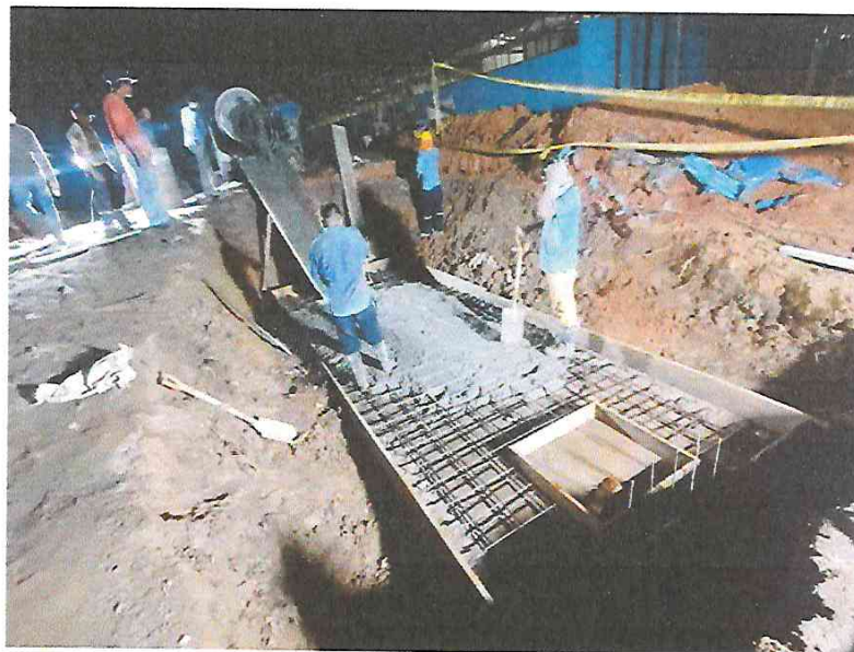
FOTO N°16: Vista del vaceo de techo para el tanque séptico en la obra "Mejoramiento y Equipamiento del servicio Educativo N° 62200 Barrio Carabanchel - San Lorenzo, Distrito Barranca, Provincia Datem Del Marañón - Loreto".
