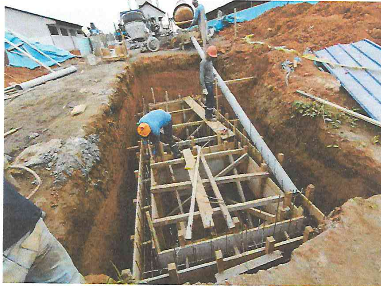
FOTO N°07: Vista del vaciado de muros del tanque séptico en la obra "Mejoramiento y Equipamiento del servicio Educativo N° 62200 Barrio Carabanchel - San Lorenzo, Distrito Barranca, Provincia Datem Del Marañón - Loreto".
