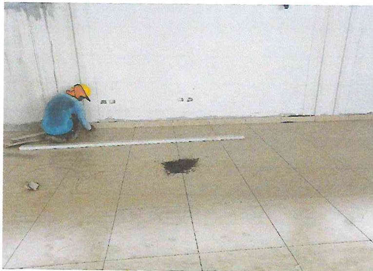
FOTO N°20: Vista de enchapado del contrazocalo en módulo A- SUM en la obra "Mejoramiento y Equipamiento del servicio Educativo N° 62200 Barrio Carabanchel - San Lorenzo, Distrito Barranca, Provincia Datem Del Marañón - Loreto".
