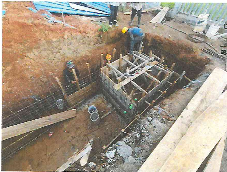
FOTO N°04: Vista del enmallado de muros del tanque séptico en la obra "Mejoramiento y Equipamiento del servicio Educativo N° 62200 Barrio Carabanchel - San Lorenzo, Distrito Barranca, Provincia Datem Del Marañón - Loreto".
