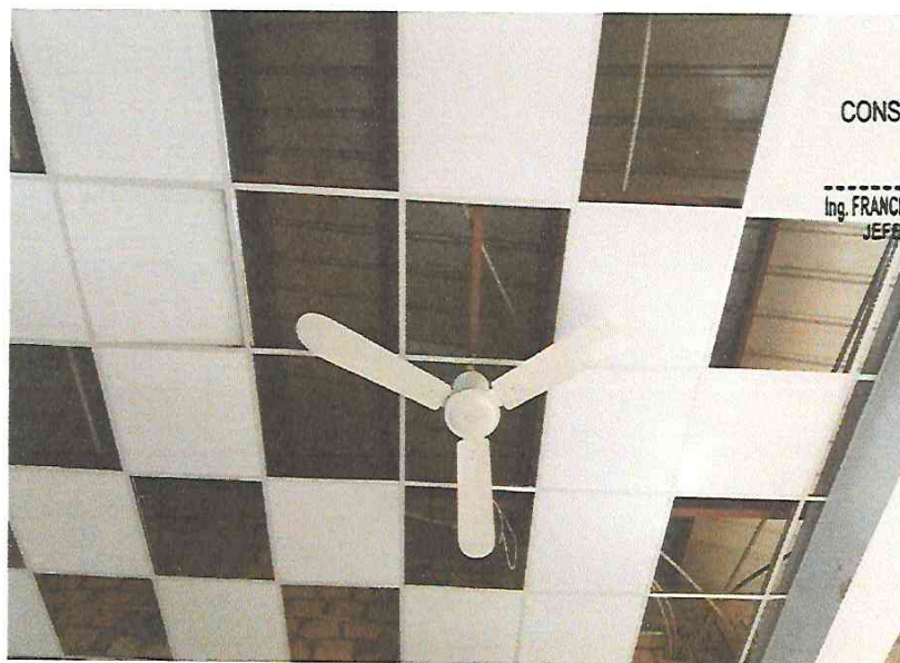
FOTO N°18: Vista de colocado del cielo raso en modulo A en la obra "Mejoramiento y Equipamiento del servicio Educativo N° 62200 Barrio Carabanchel - San Lorenzo, Distrito Barranca, Provincia Datem Del Marañón - Loreto".
