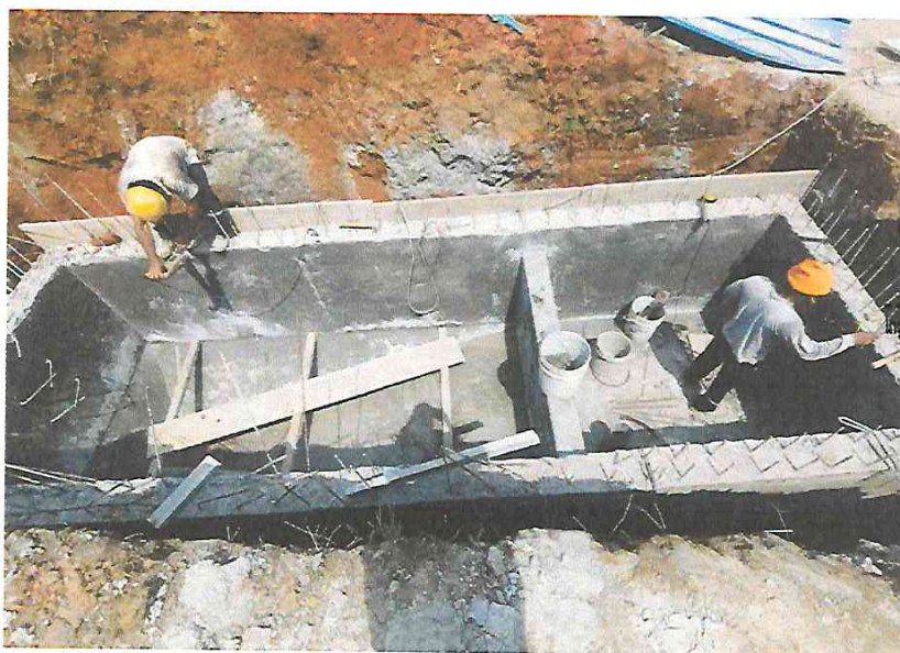
FOTO N°14: Vista del tarrajeo interior terminado del tanque séptico en la obra "Mejoramiento y Equipamiento del servicio Educativo N° 62200 Barrio Carabanchel - San Lorenzo, Distrito Barranca, Provincia Datem Del Marañón - Loreto".
