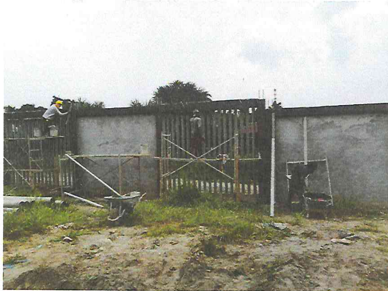
FOTO N°01: Vista de los trabajos de tarrajeo frotachado de columnas y vigas del muro perimétrico tramo 3 de la obra "Mejoramiento y Equipamiento del servicio Educativo N° 62200 Barrio Carabanchel - San Lorenzo, Distrito Barranca, Provincia Datem Del Marañón - Loreto".
