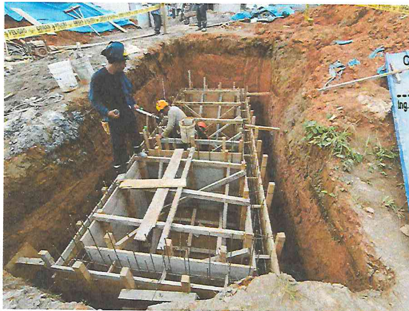
FOTO N°06: Vista del encofrado del tanque séptico en la obra "Mejoramiento y Equipamiento del servicio Educativo N° 62200 Barrio Carabanchel - San Lorenzo, Distrito Barranca, Provincia Datem Del Marañón - Loreto".
